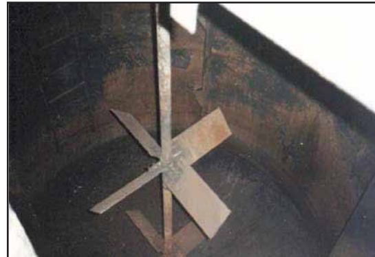
Tanque corroído debido a la falla del recubrimiento.
