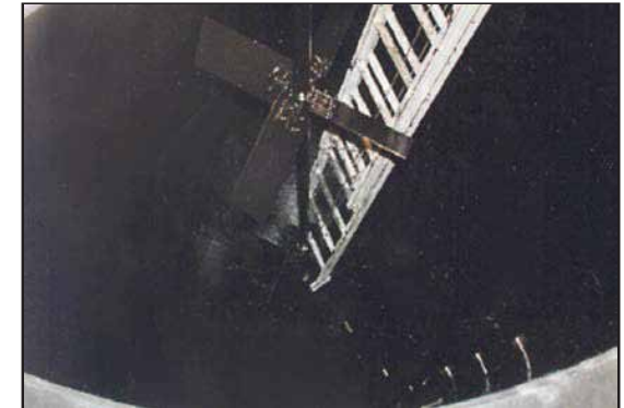
Tanque y agitador protegidos con ARC 855.
